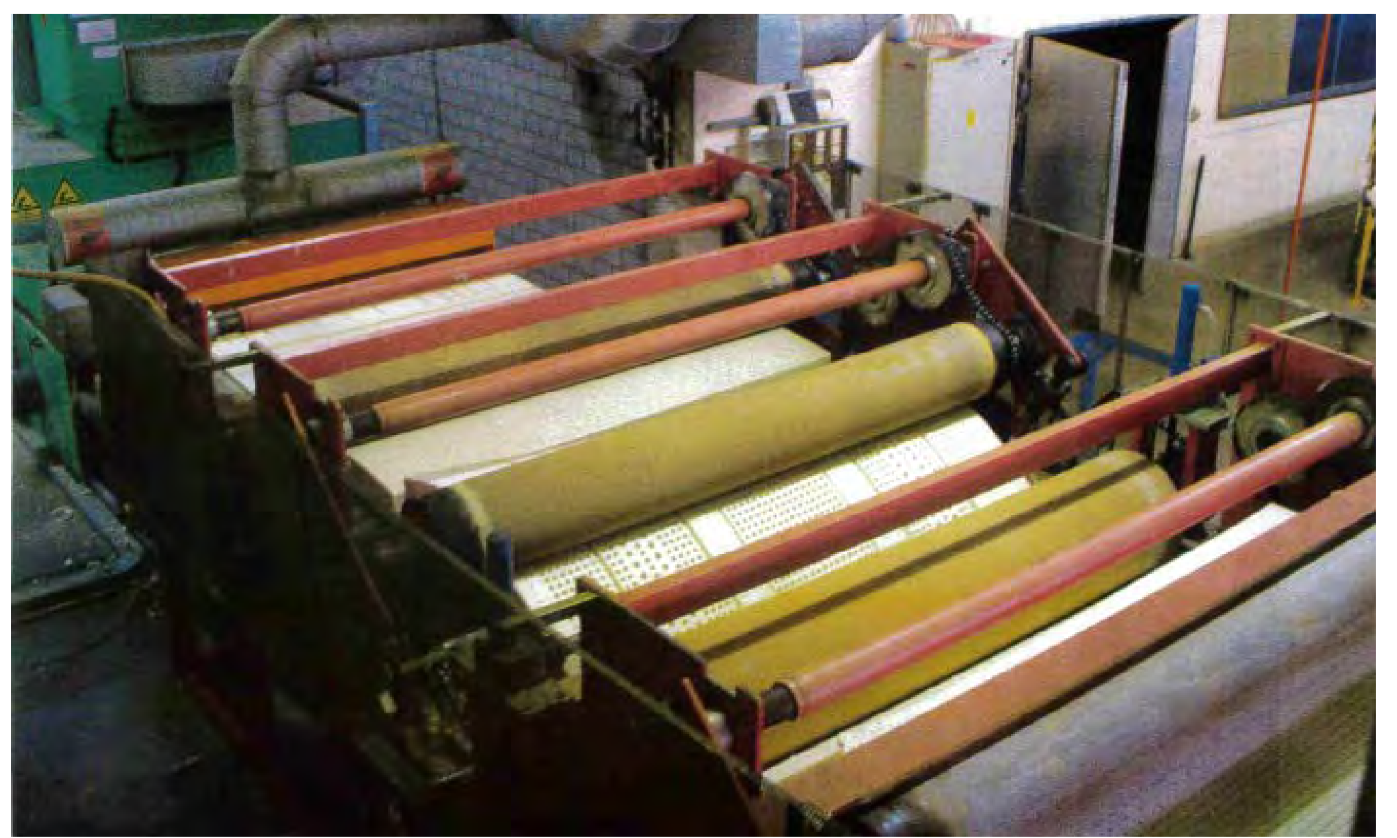
„S-92“ Waschanlage für Latexteile
