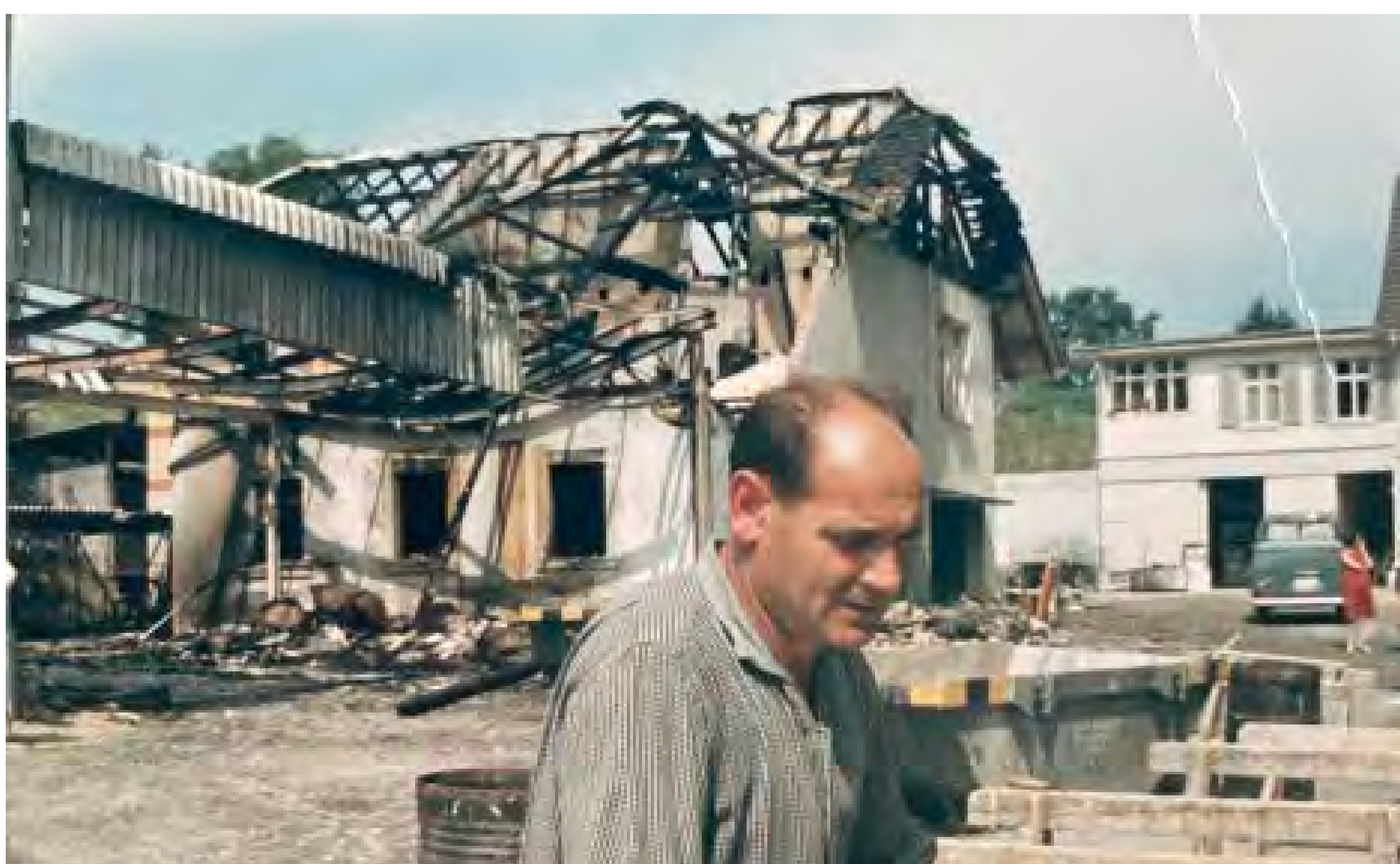
Brand im Lagergebäude, einer ehemaligen Rossstallung (1967)
